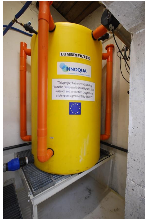
Installation à Vasto, Italie
